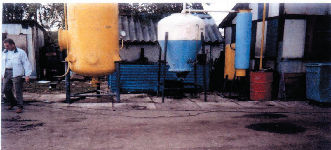
Рис.5.1. Экспериментальные испытания многотрубной пиролизной установки на полигоне «Торбеево», в 2006г.
