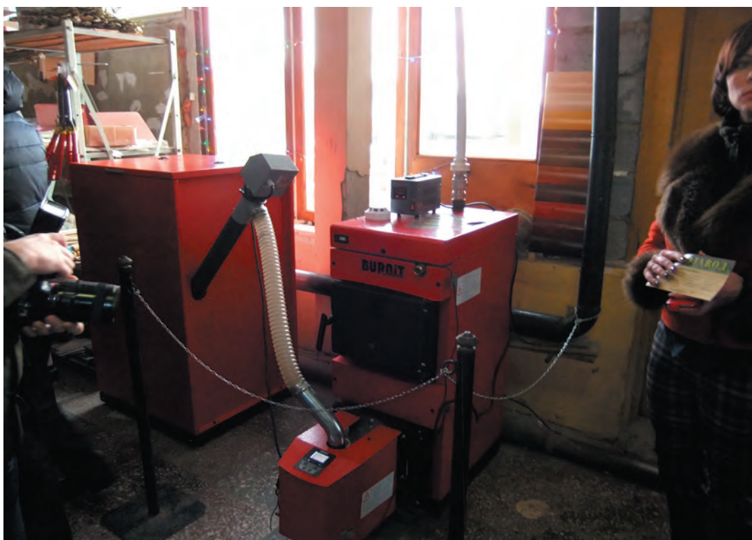
Рис. 4.3. Пеллетный котёл мощностью 40 кВт для обогрева помещения сельского магазина.
